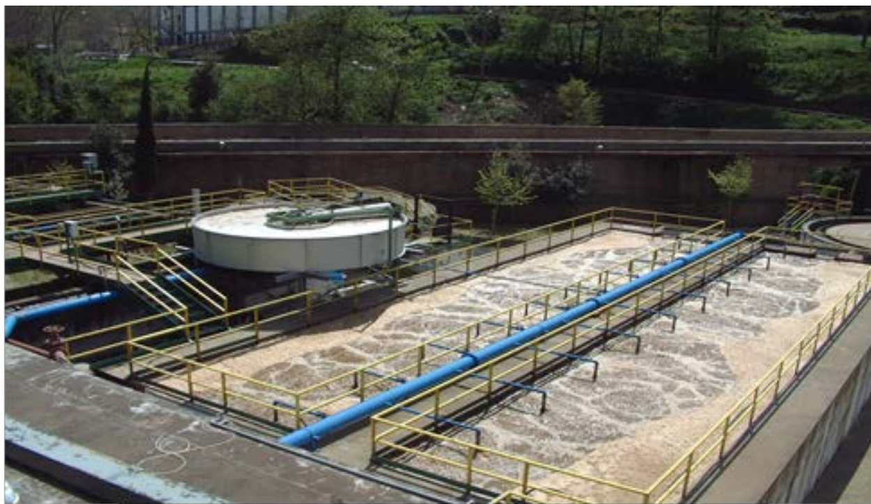
VISTA DELL'IMPIANTO DOPO IL REVAMPING
